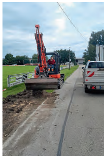
Bankettbefestigung in der Egerlandstraße
